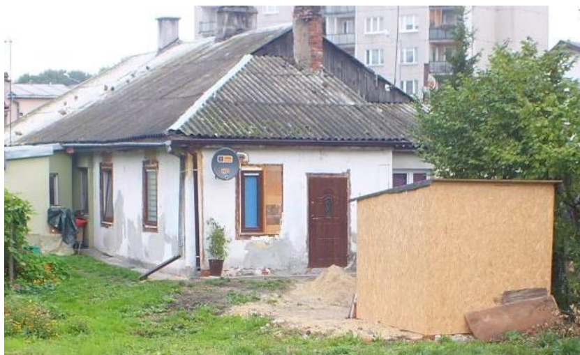
Zdjęcie 7. Widok pokrycia dachowego z wyrobów zawierających azbest w dolinie Huczwy w Hrubieszowie
