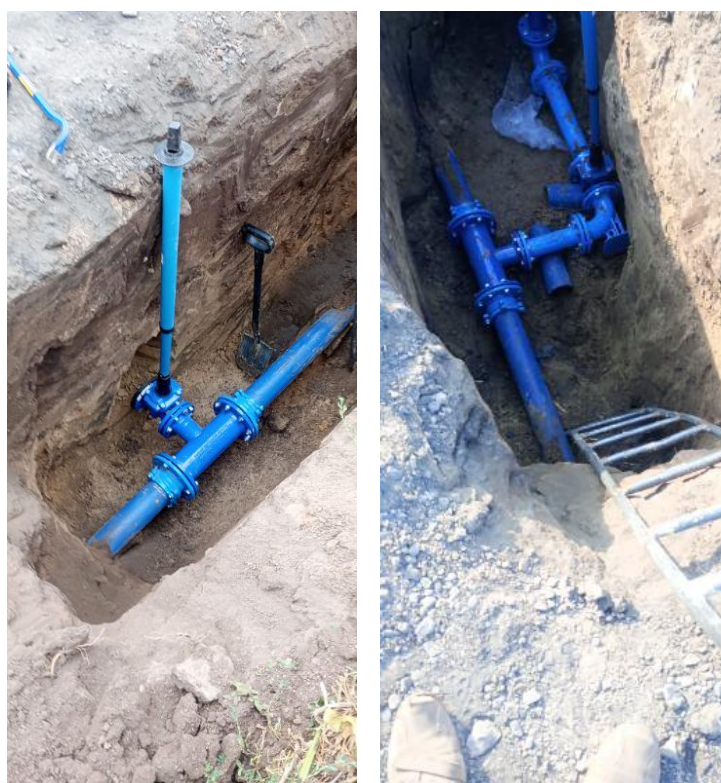
Fot.: PGK i M. Budowa sieci wodociągowej w ulicy zielony zakątek w Hrubieszowie (etap A-B)
